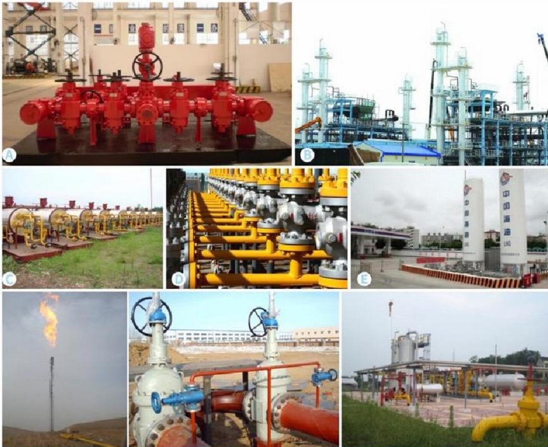
天然气放空装置 Gas Venting Device
